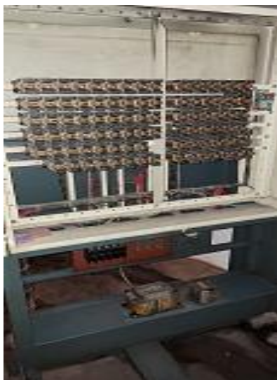
Quadro de comando/seletor existente no Edifício
