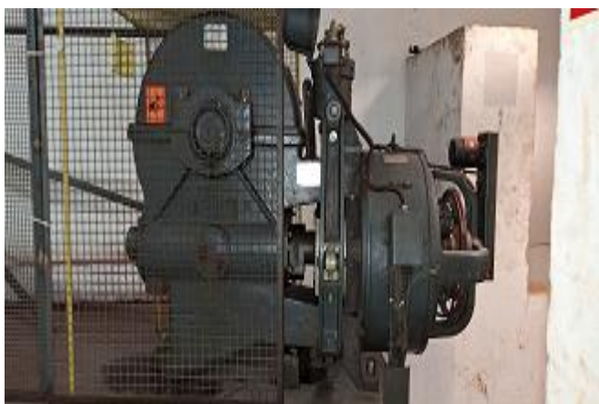
Conjunto de tração existente no Edifício
