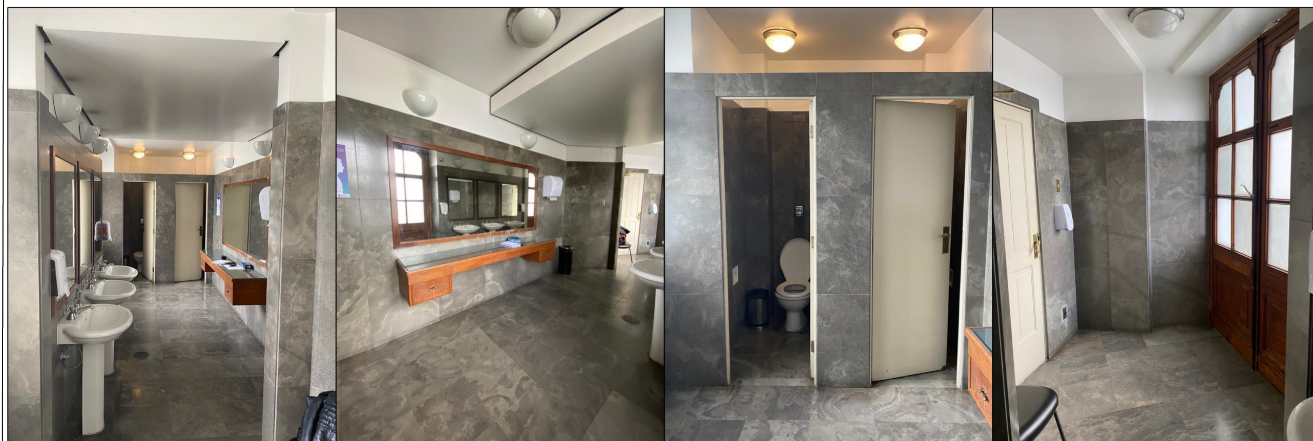
FOTO 1 - SANITÁRIO FEMININO LADO PAR FOTO 2 - SANITÁRIO FEMININO LADO PAR FOTO 3 - SANITÁRIO FEMININO LADO PAR FOTO 4 - SANITÁRIO FEMININO LADO PAR
