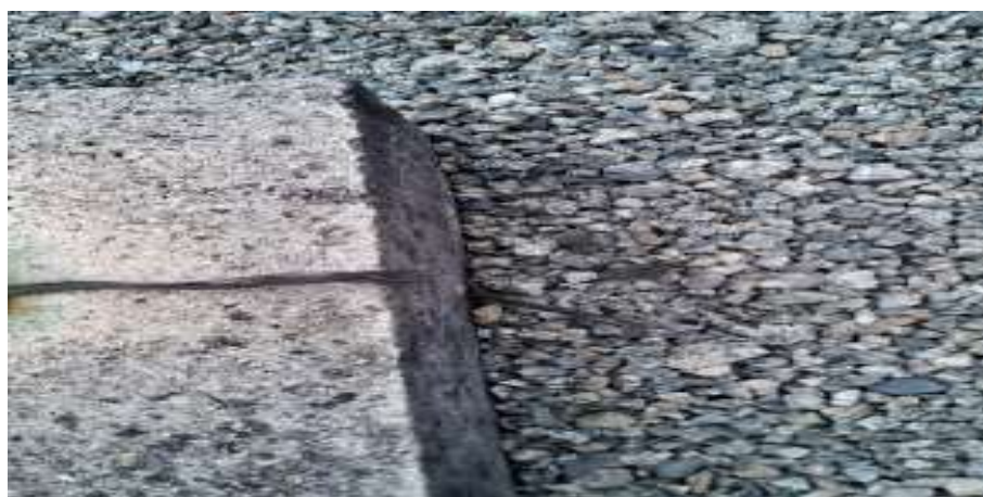
Foto: Mastro com captadores Franklin com cabo cortado.
