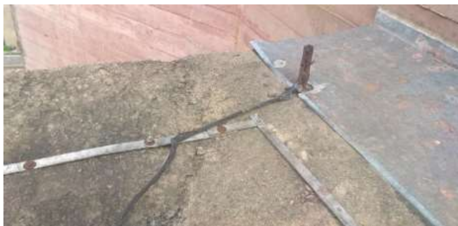
Foto: Conexão a malha de aterramento (enferrujado)
