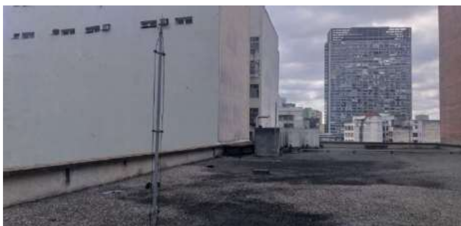
Foto: Mastro com captadores Franklin
