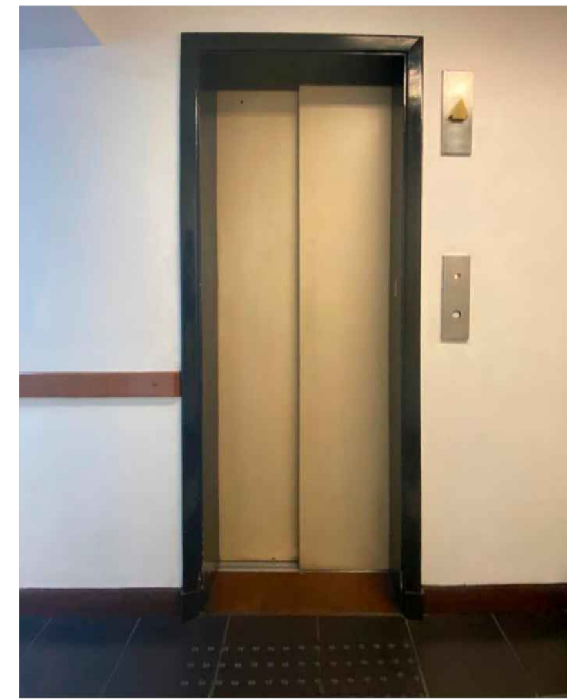
FOTO 1 - ELEVADOR DOS BASTIDORES LADO ÍMPAR
